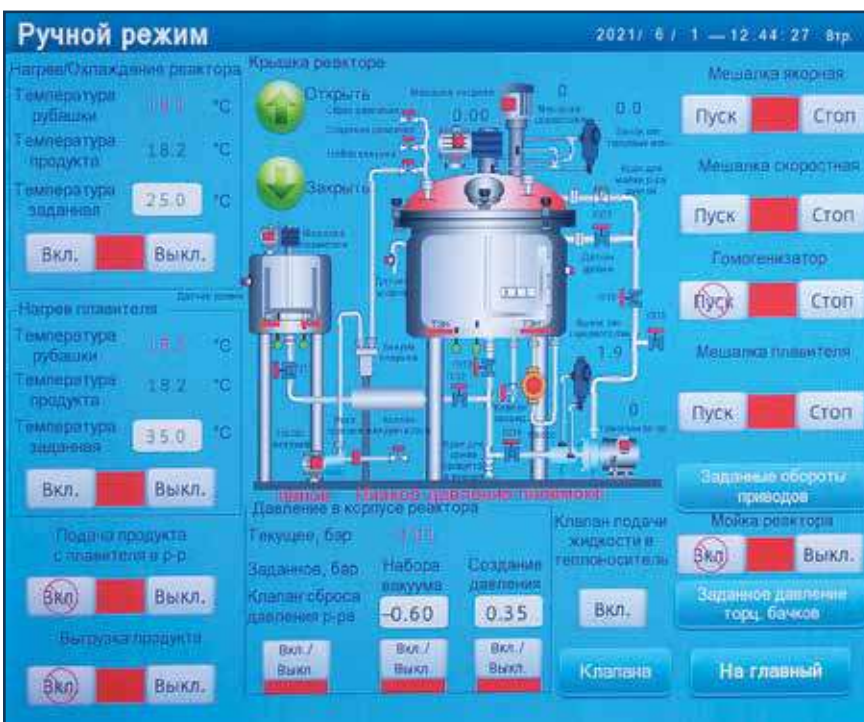
Панель PLC пульта управления
